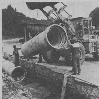
Das Doppelrohr wird in den Graben gebracht, nachdem unmittelbar zuvor das Innenrohr mit Hilfe des Baggers ins Aussenrohr geschoben wurde
