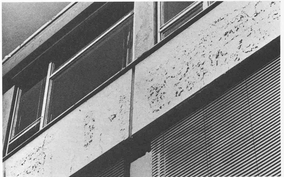
Bei ungenügend abgedeckter Bewehrung entstehen durch thermische Belastungen Volumenveränderungen, die zur Rissbildung führen
