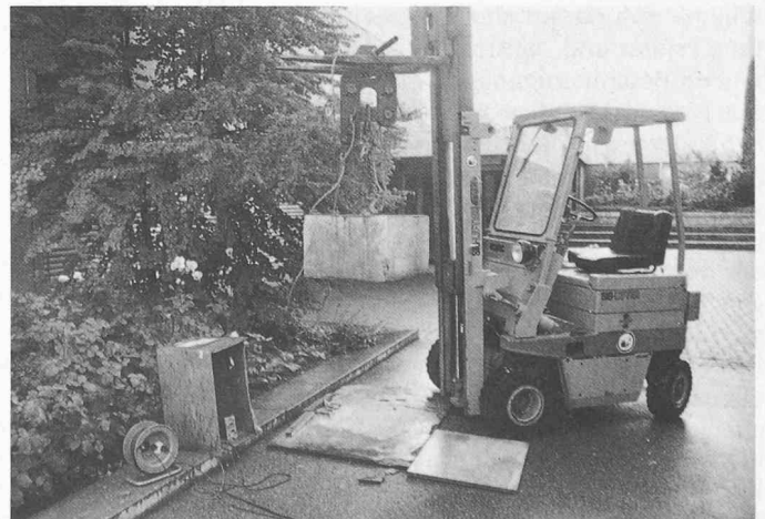
Bild 2. Der an einer Ausklinkvorrichtung hängende Betonquader wurde mit einem Hubstapler auf die notwendige Fallhöhe angehoben
