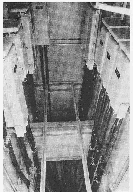
Bild 9. Kabelstützpunkt für Umschaltmöglichkeit im Störfall
