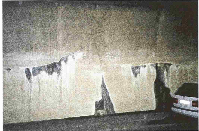
5 Wassereintritte durch Risse im Tunnelgewölbe infolge Wasserdruckaufbau
