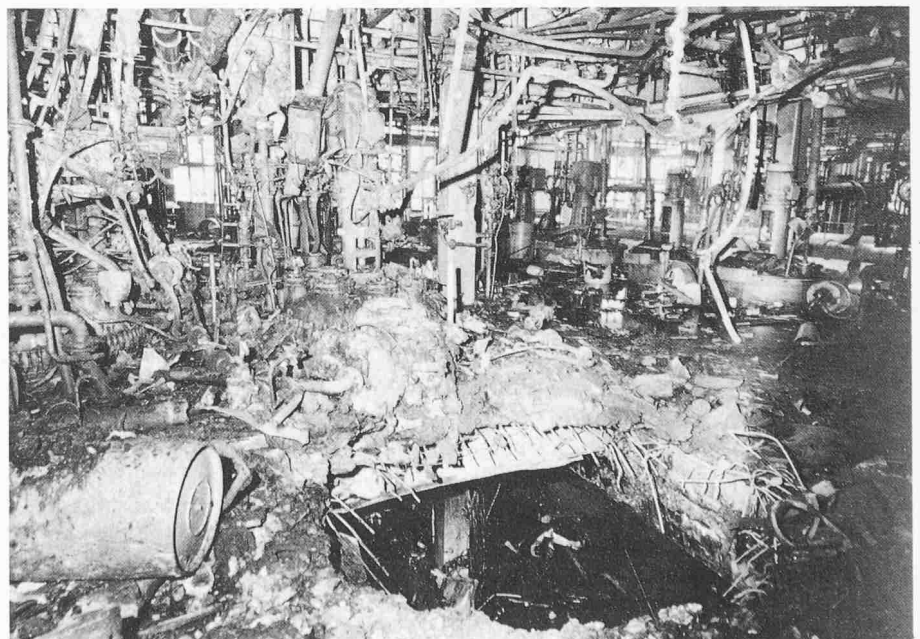
Bild 1. Explosion in einem Chemiewerk. Die Wucht der Explosion zerriss auch die armierte Betondecke
