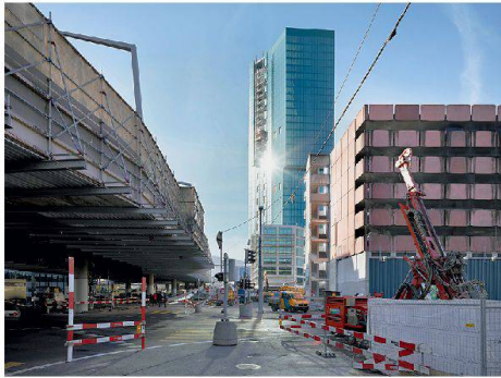
An der Hardstrasse im Zürcher Industriequartier werden die Hardbrücke saniert und der «Prime Tower» gebaut (Foto: Hannes Henz)
