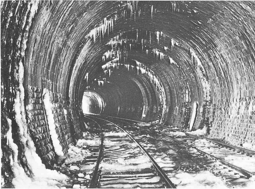
Bild 1. Älterer Eisenbahntunnel vor der Instandsetzung
