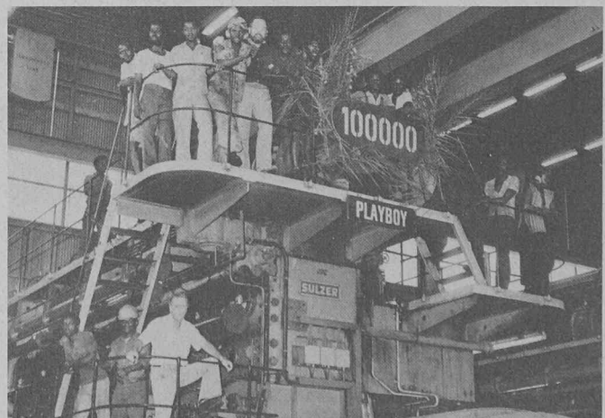
Fig. 2. — Un des moteurs diesel Sulzer 9RF68 à marche lente qui ont été installés en 1965 dans la centrale motrice de 100 MWe à Bong Range. Ce moteur fonctionnant à l'huile lourde a atteint récemment une durée d'exploitation de 100 000 h. de service.
