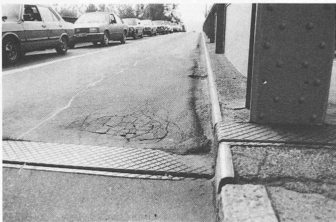
Bild 4. B-003 Rheinbrücke Koblenz-Waldshut. Rosettenförmige Risse im Belag deuteten vor der Sanierung auf Schäden an der Betonoberfläche
