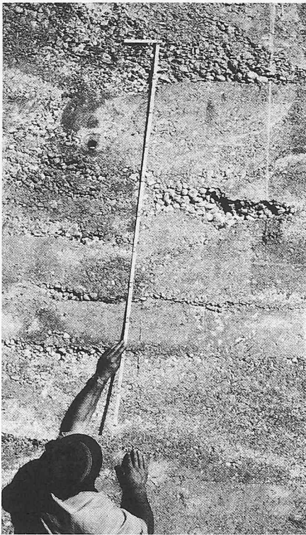
Bild 2. B-065 Hochbrücke Baden, Pfeiler. Schlecht verdichteter Stampfbeton. Man erkennt die eingebrachten Schichten. Foto EMPA 57492/15a (Bild 2 und 3 aus EMPA-Bericht Nr. 69 082 vom Okt. 69)
