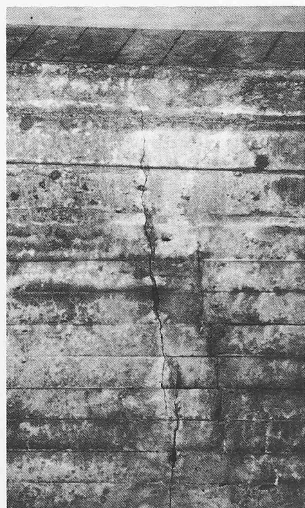
Bild 5. Risse in der Konsole einer Überführung über die N3 bei Rheinfelden. Ansicht von unten
