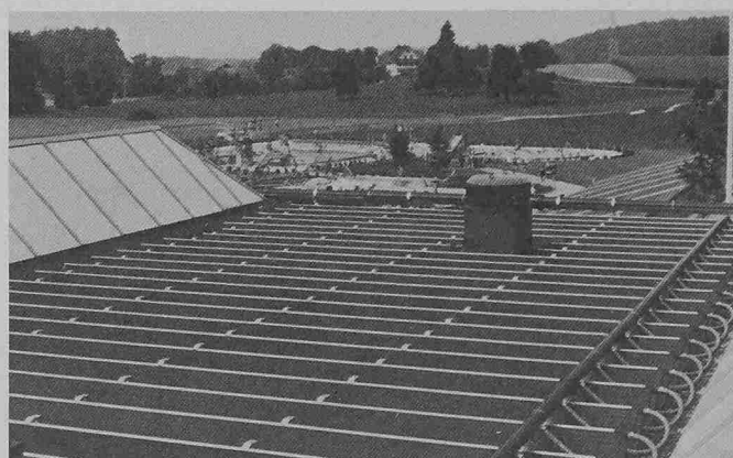
Auf dem Turnhallendach verlegte Niedertemperatur-Kunststoffkollektoren Sessa Exro erwärmen direkt das Schwimmbadwasser der Freibadanlage Bachmatten in Muri (AG)
