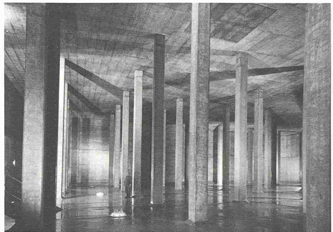
Bild 8. Trinkwasser-Reservoir mit unverputzten Wänden
