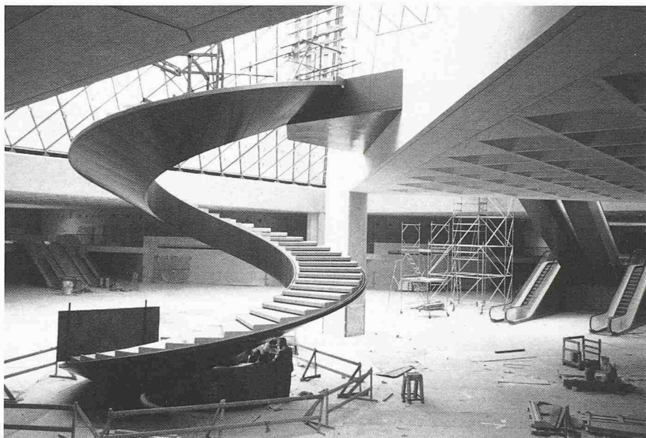
Bild 10. Die verblüffende und bewegliche Verbindungstreppe, die wie ein Lift die verschiedenen Ebenen des Eingangsfoyers unter der Glaspypamide des Louvre miteinander verbindet
