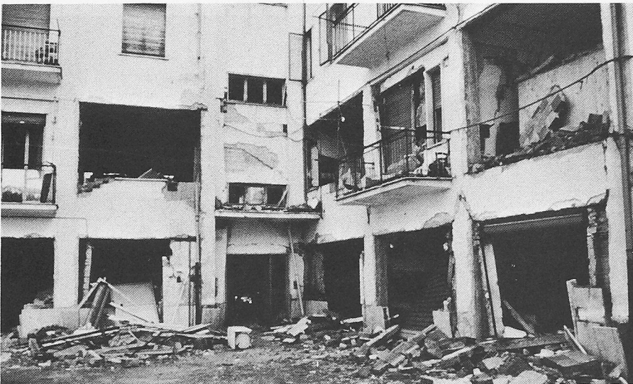
Bild 19. Vollständig zerstörte Ausfachungs- und Zwischenwände im Erdgeschoss und im 1. Stock eines L-förmigen Gebäudes in San Angelo dei Lombardi (Intensität IX)
