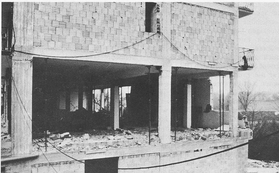
Bild 23. Vollkommen zerstörte Ausfachungs- und Zwischenwände im Erdgeschoss eines Gebäudes in Lioni (Intensität IX). Die Backsteine sind liegend eingesetzt. Die Stützenköpfe sind häufig stärker beschädigt als die -füsse
