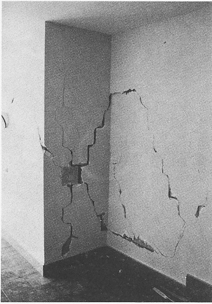
Bild 16. X-förmige Risse im Eingang eines 10stöckigen Stahlbetonskelettbauwerks in Avellino als typischer Schaden bei Intensität VII
