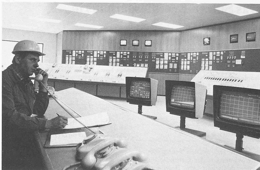
Bild 1. Kommandoraum einer Grossanlage, in dem sowohl neue wie auch konventionelle Technik zur Anwendung gelangt
