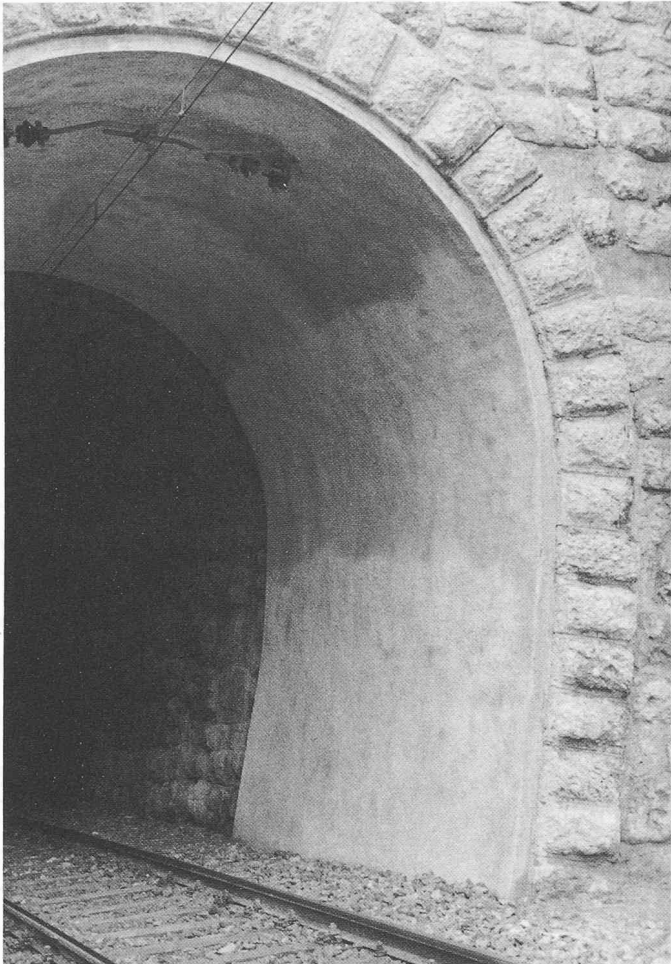
Bild 7. Unterschiedlicher Grauton («Wolkung») nacheinander ausgeführter Spritzbetonflächen
