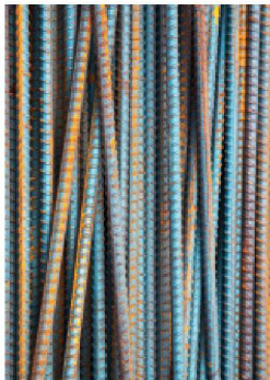
Angerostete Bewehrungsstäbe (KEYSTONE/CARO/Felipe Rodriguez)
