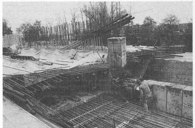
Bild 13. Produktionsstelle Widerlager Nord. Vorschoben mittels einer einzigen Presse (720 t), die am Mittelträger angesetzt ist
