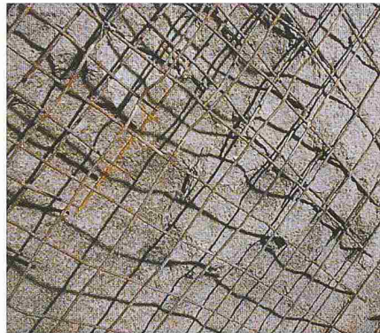
1 Zerstörter Beton und freigelegte Armierung nach Brandbelastung
