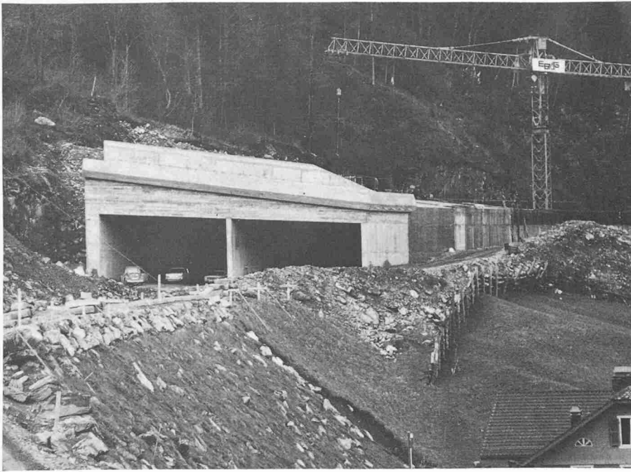
Bild 8. Die Galerie Fischlauri ist ein im Tagbau erstellter Tunnel, durch den das Normalprofil unverändert hindurchgeführt wird. Die talseitige Längswand wird gänzlich eingefüllt. Auf dem Galeriedach quert ein Waldweg den durch Leitwerke seitlich begrenzten Lawinenzug
