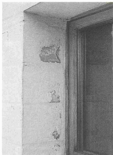
Bild 9. Anstrichablösungen und Ausblühungen auf einem Kalksandsteinmauerwerk
