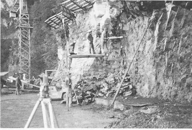
Bild 6. Ausbruch des Widerlagerriegels
