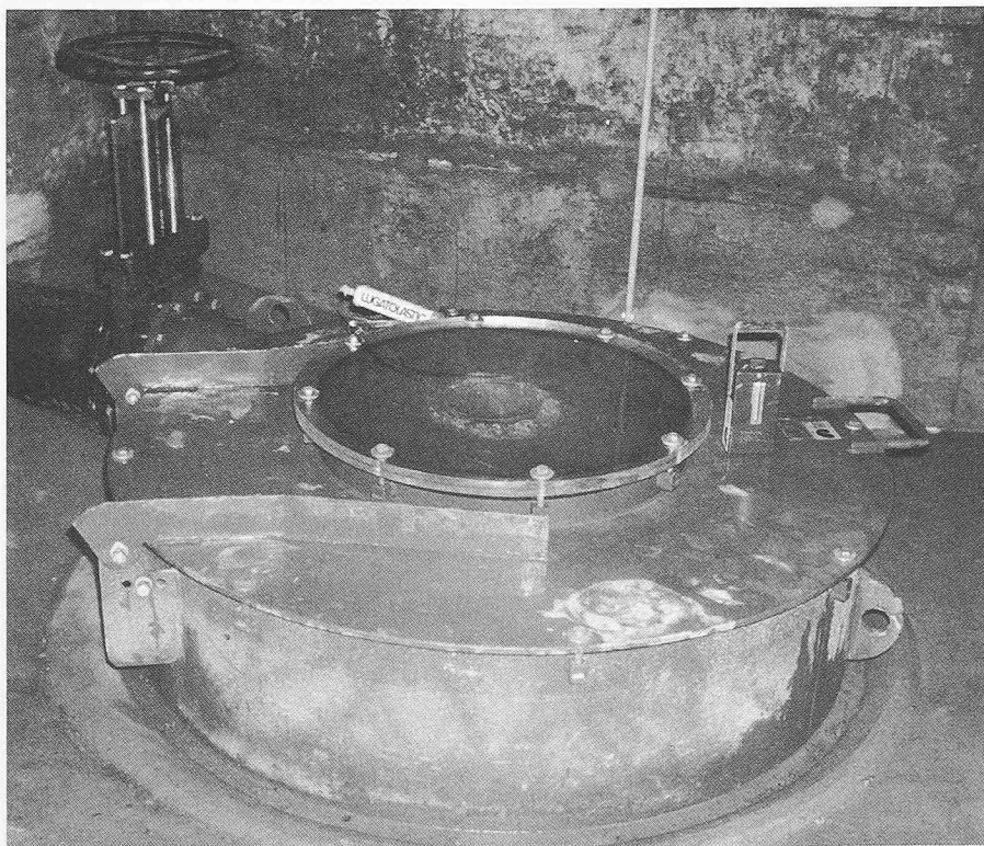
Bild 9. Wirbeldrossel Typ A, NW 300 mm, am Regenbecken «Schoren» der Stadt St. Gallen. Durch das Fenster ist der Wirbelkern zu sehen
