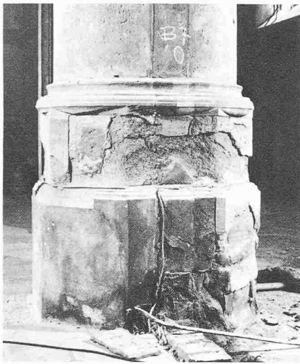
Bild 3a. Pfeiler B7. Die «elektro-physikalische Mauerrockenlegung» hat die Zerstörung des Steingefüges nicht verhindern können (Aufnahme: Mai 1975)
