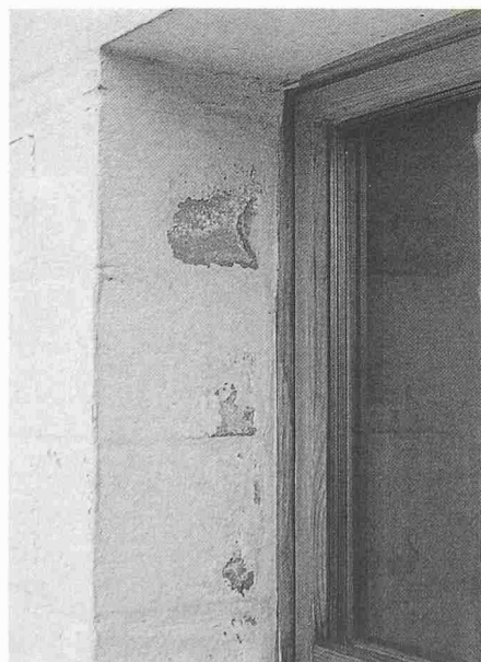
Bild 9. Anstrichablösungen und Ausblühungen auf einem Kalksandsteinmauerwerk
