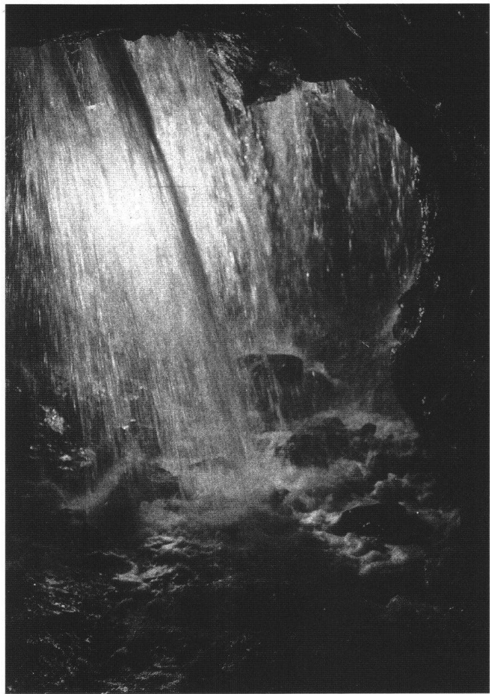
Fig. 5: Zulaufstollen Handeck-Chapf: Lokale Wassereintritte von ca. 400 l/sec.
