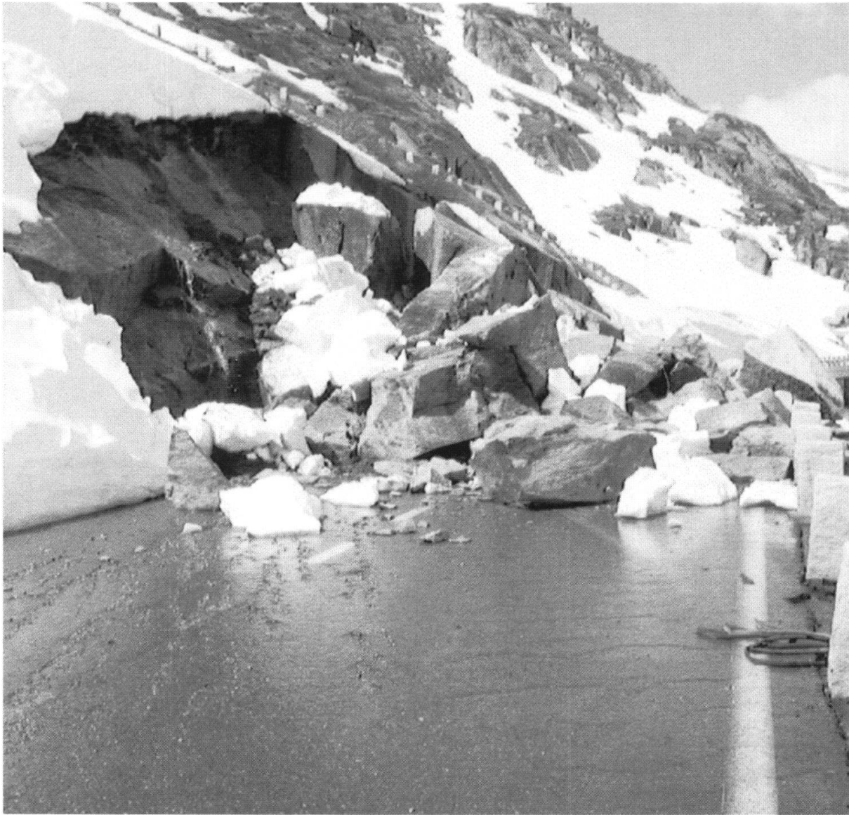
Fig. 12: Abgeglittene Granitplatten an der Grimselpassstrasse.
