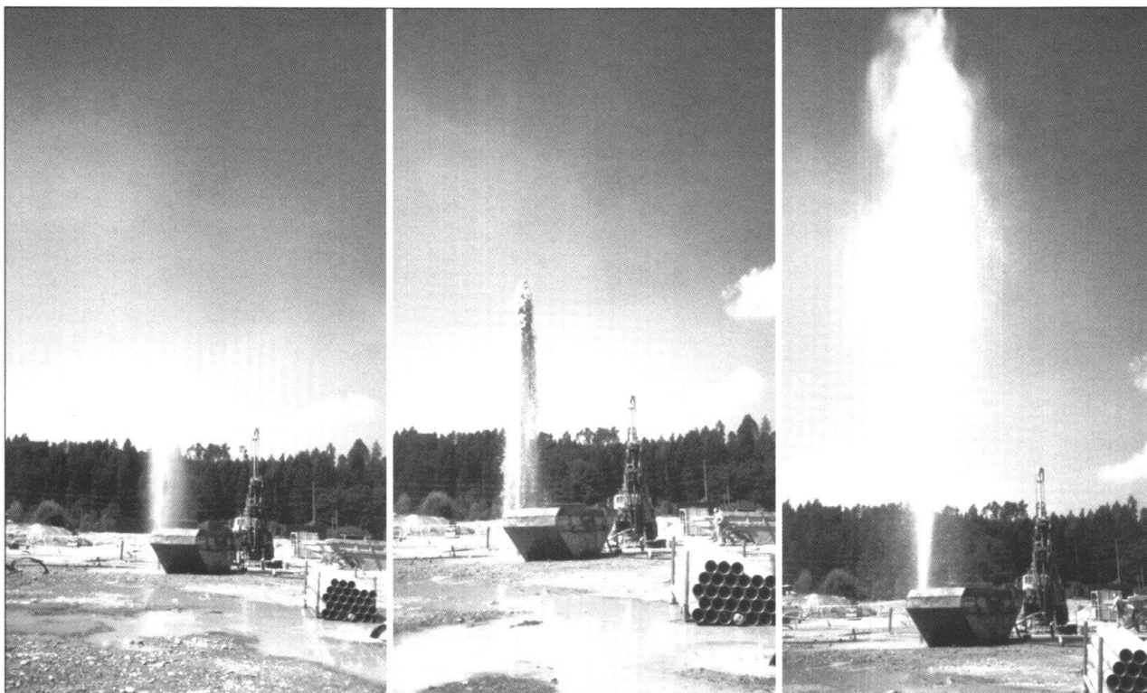
Fig.14: Rund 30 m hoher «Blow Out» aus der Pilotbohrung beim Spülen des 12 m entfernten Sondenlochs Nr. 26.
