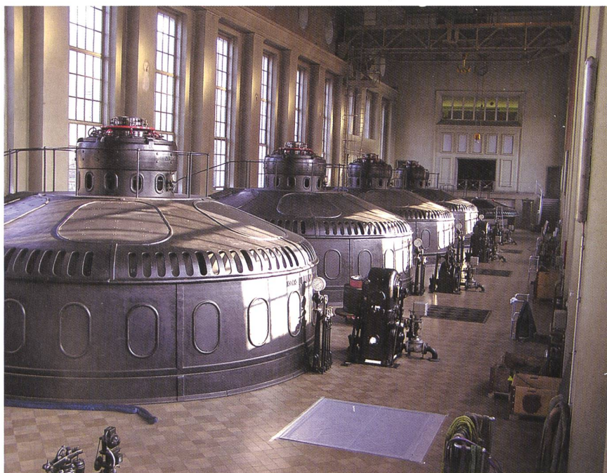
Im Innern des Maschinenhauses.
