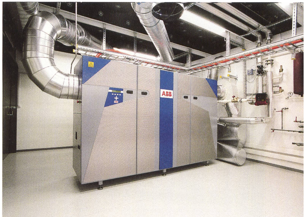
Bild 1 Erste als Kraft-Wärme-Kopplungs-Anlage (KWK) funktionierende Mikroturbine im ABB-Forschungszentrum Baden-Dättwil.
