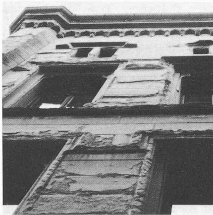
Bild 5a. Ist-Zustand vor Sanierung. Verwitterung
