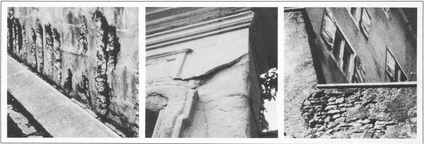
Bild 2. Ist-Zustand für Bauschadensanierung
