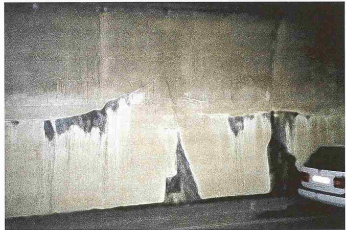
5 Wassereintritte durch Risse im Tunnelgewölbe infolge Wasserdruckaufbau
