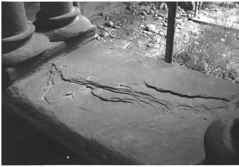
Fig. 108 Tablette en cours de traitement. Des trous ont été percés à travers les plaques de litage de la molasse, pour permettre l'injection du consolidant. Le traitement a été effectué à l'aide de seringues, mais aussi par la pose de sacs de goutte-à-goutte dont le débit était réglé pour que le produit s'écoule sans déborder.
