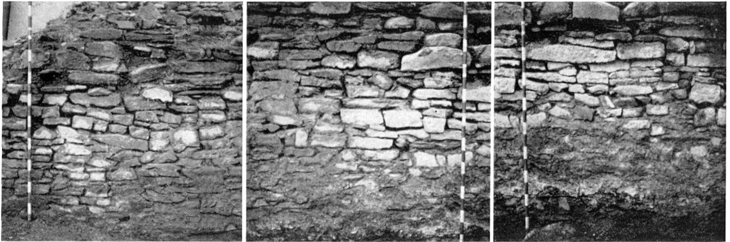
1) Nordmauer des Hauptgebäudes, Ausschnitte. Man beachte die übereinanderliegenden Stoßfugen!
