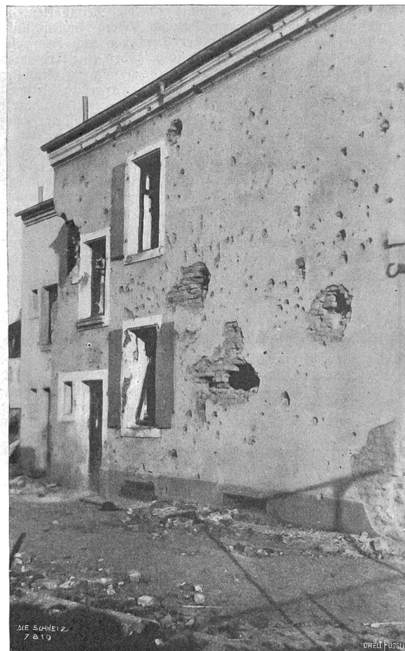
Durch Schrapnells und Flintenschüsse zerstörtes Haus in Illberg-Dornach (Elsass). Phot. Willy Schneider, Zürich.
