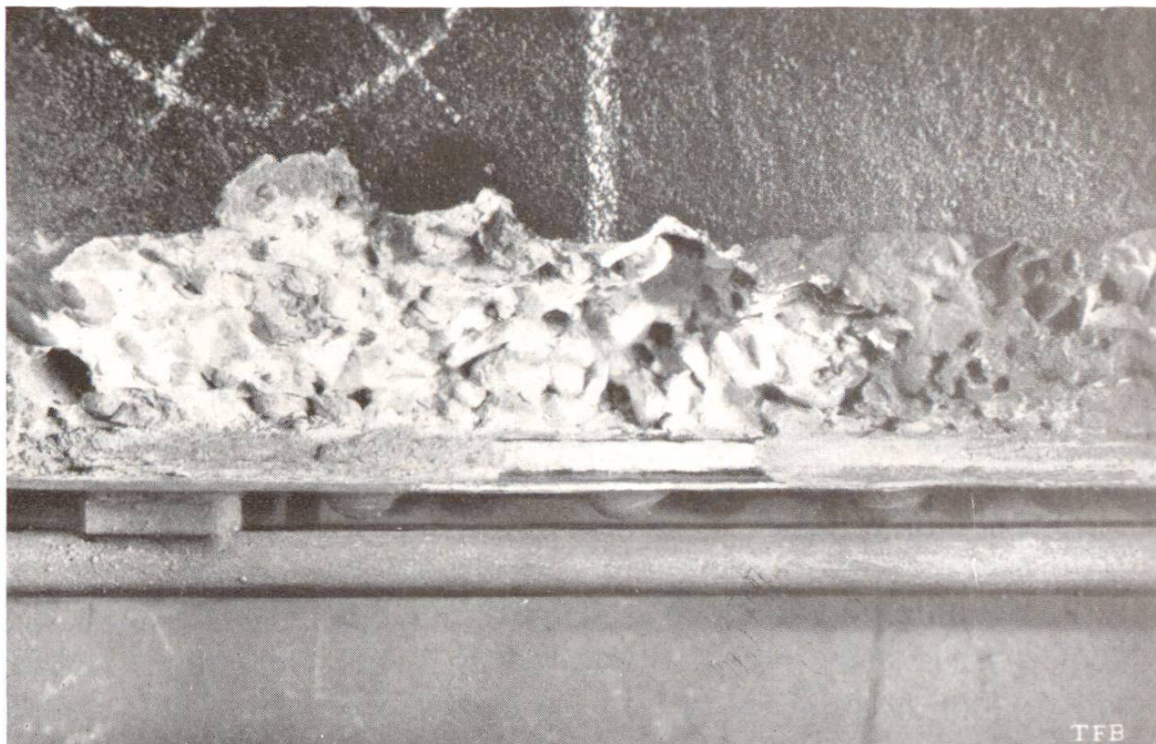
Abb. 2 Abgerostete Untergurten werden durch angeschweisste Rundeisen wieder tragfähig gemacht und gunitiert.
