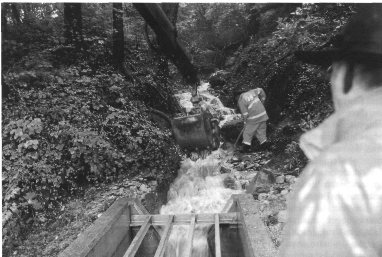
Heftige Regenfälle im August haben auch in Ausserrhoden Schäden angerichtet, doch sind diese im Vergleich mit anderen Landesteilen vergleichsweise harmlos geblieben. (Bild: David Scarano)
