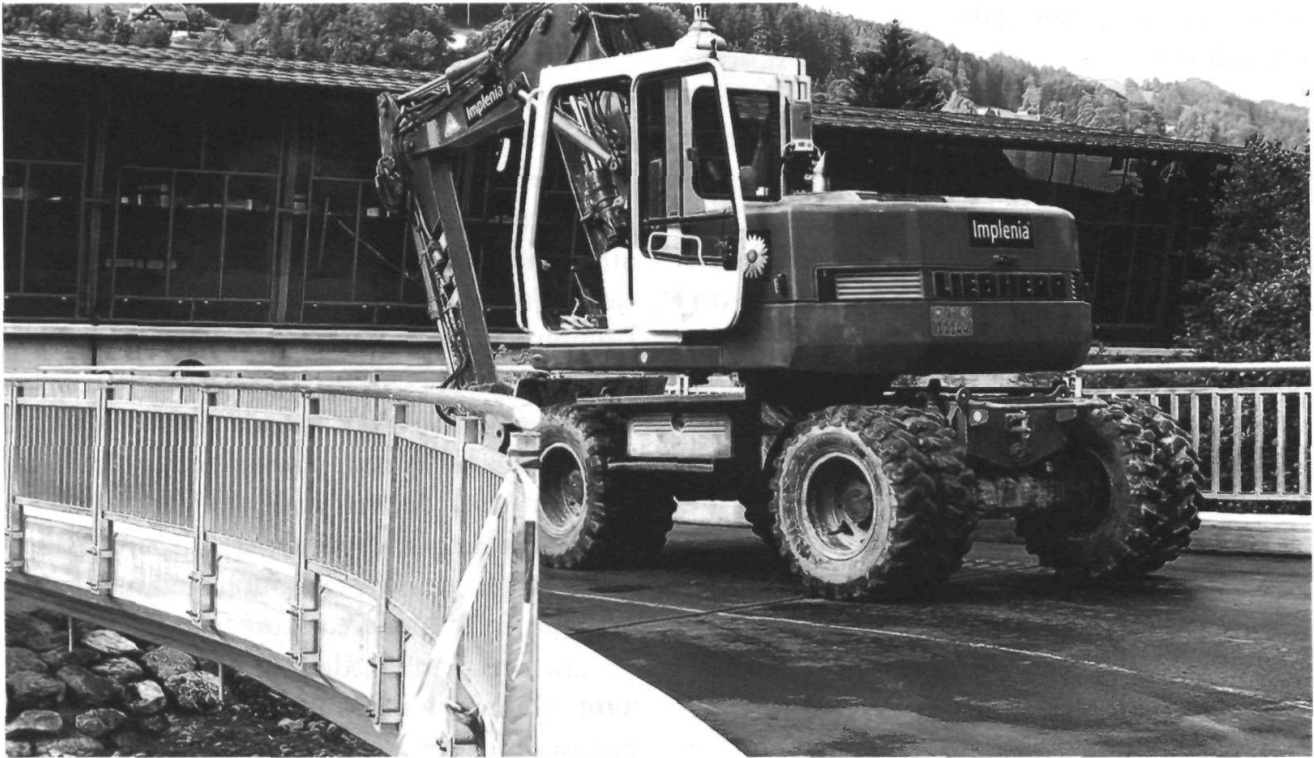
Die Brücke über den Rotbach, mit deren Bau einiges Ungemach verbunden gewesen war, konnte im Juni dem Verkehr übergeben werden. (Bild: Martin Kradolfer)
